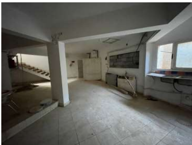
Fig. 4 - Dettaglio finestra murata
