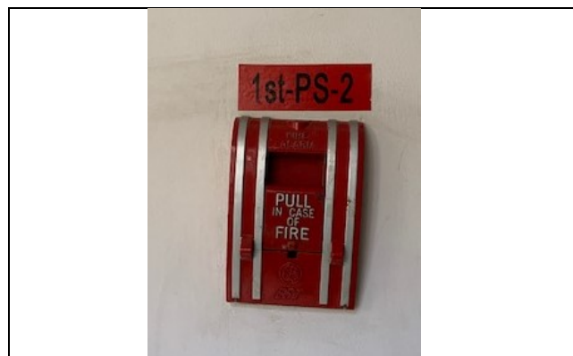
Pulsante allarme incendio (posto in diversi punti della struttura)
